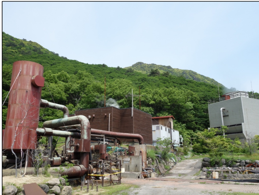
九重地熱発電所
