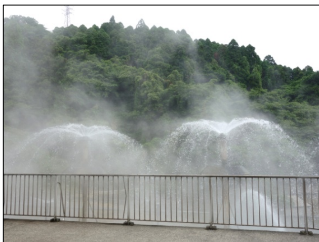
冷却散水設備
