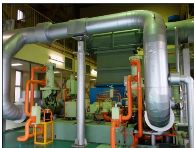
発電所内部 発電設備
