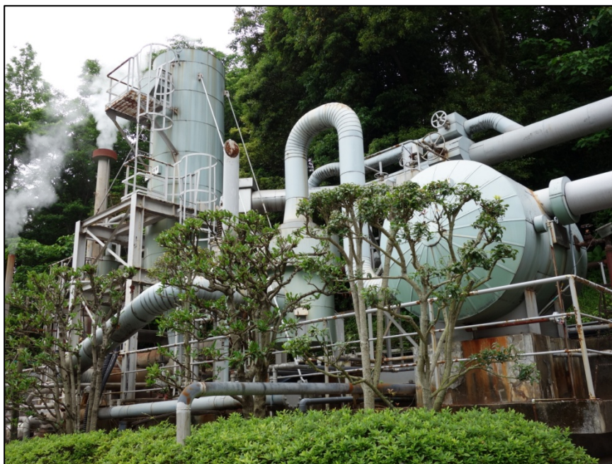
Sホテル地熱発電所 発電設備 蒸気井・気水分離器
